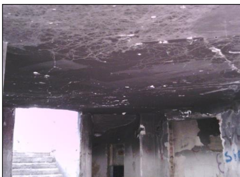
Termografia n. 1.3 senso di armatura del solaio ad ingresso e soletta piena lato scala
