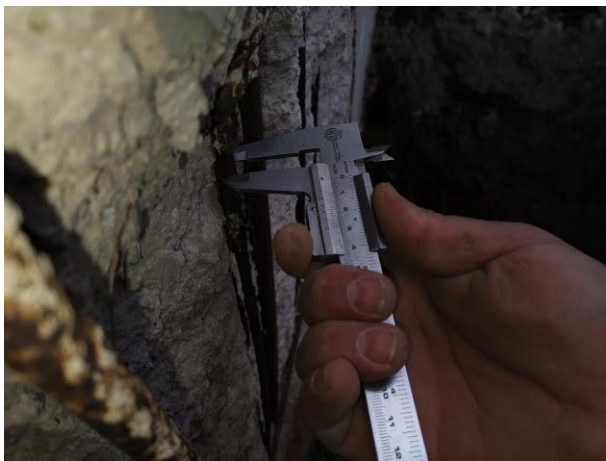
Foto 7 – Stato di ossidazione degli acciai e misura diametro delle barre
