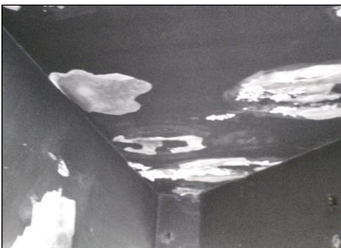
Termografia n.2.2 senso di armatura del solaio zona palco, alla sinistra del palco.
