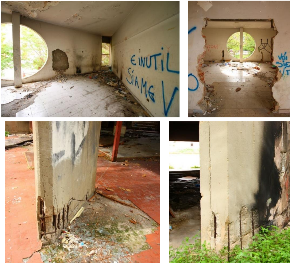
Fig. 9. Stato di fatto - Degradi della struttura
