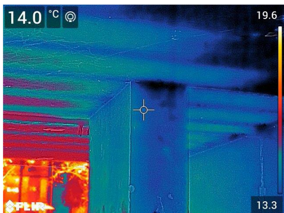
Figura 13: Indagine termografica del solaio di ingresso
