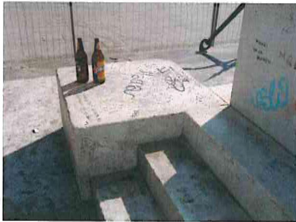
Punti in cui la recinzione è mancante
