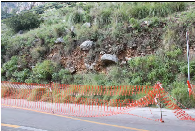
Foto 3 – Settore (A) - La presenza di blocchi poco radicati lungo la scarpata può essere causa di crolli di massi sulla sede stradale.
