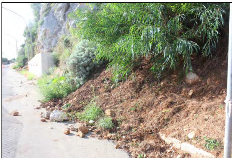
Foto 2 - Settore (B) materiale detritico frammisto a porzioni di suolo trascinati sulla sede stradale dall'azione erosiva dalle acque di ruscellamento
