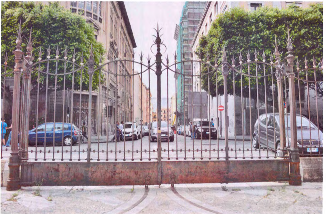
H – CANCELLO 5 – Visioni delle due facce del cancello. Il progetto prevede la dismissione del pilastro di sostegno destro (nella visione della foto in alto) per eliminarne la labilità dell'asse verticale.
