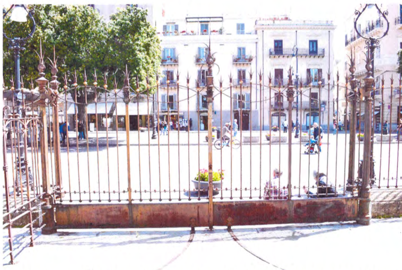
T – CANCELLO 13 – Visioni delle facce esterna (verso la piazza) ed interna (verso il parterre) cancello. Il progetto prevede la dismissione del pilastro portante destro (nella visione della foto in basso) per eliminarne la labilità dell'asse verticale.
