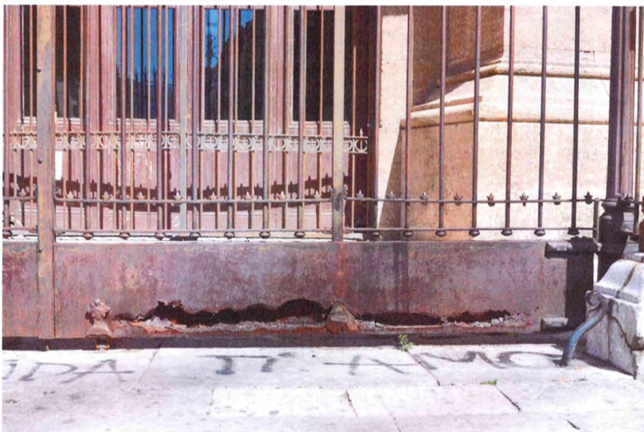
1 – CANCELLO 5 – Degradamento delle superfici delle pannellature cieche nella facciata esterna verso la piazza.
