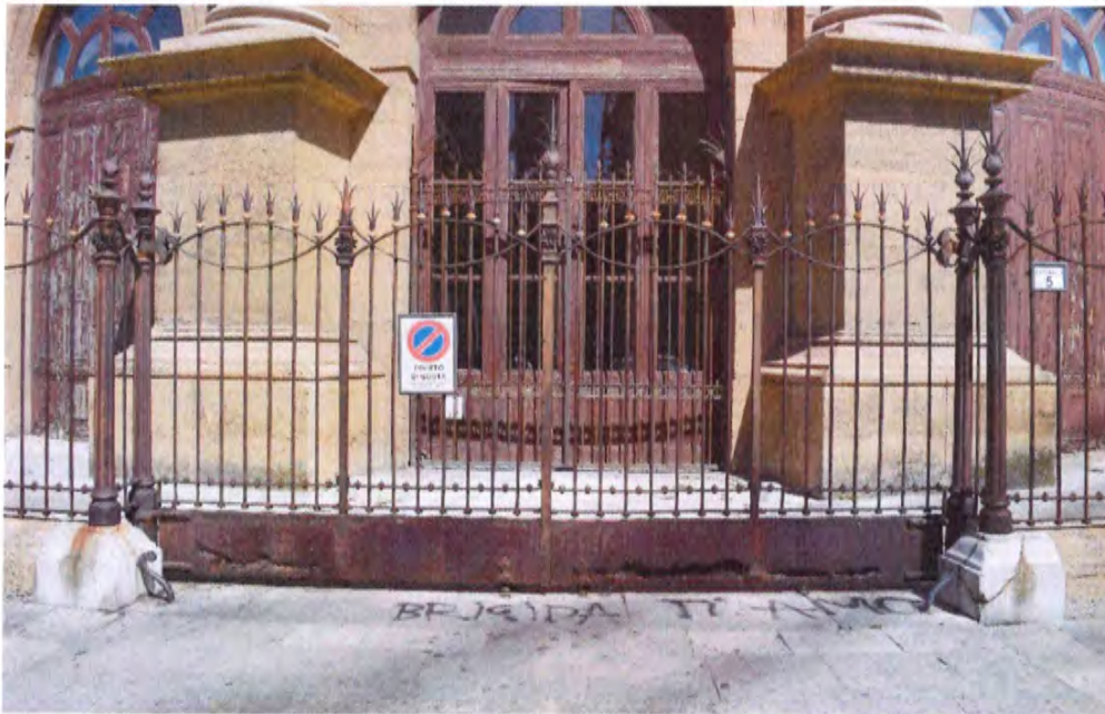
Figura 4 - Cancello 5. In evidenza l'erosione delle lamiere delle pannellature cieche.
