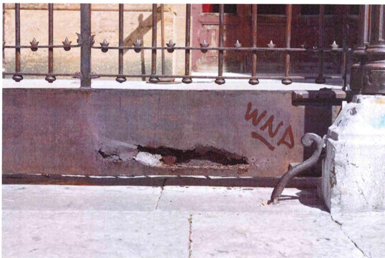
G - CANCELLO 4 - - Degradamento delle pannellature cieche (superfici delle facce verso la piazza).
