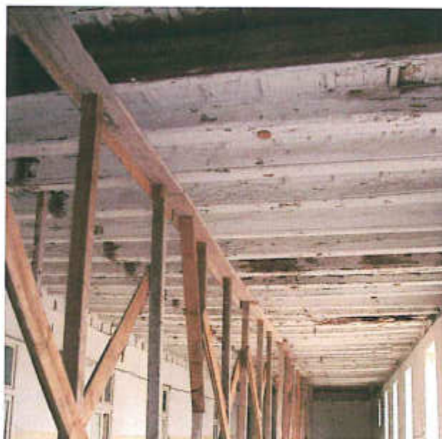
Vista intradossale del solaio del secondo piano Si noti la posizione del tramezzo sulla foto precedente, evidenziata dall'assenza di vernice su tutte le travi
