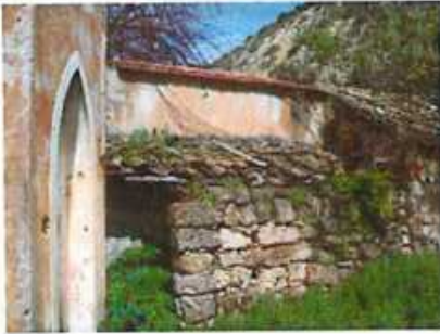
Corpi abusivi da demolire
