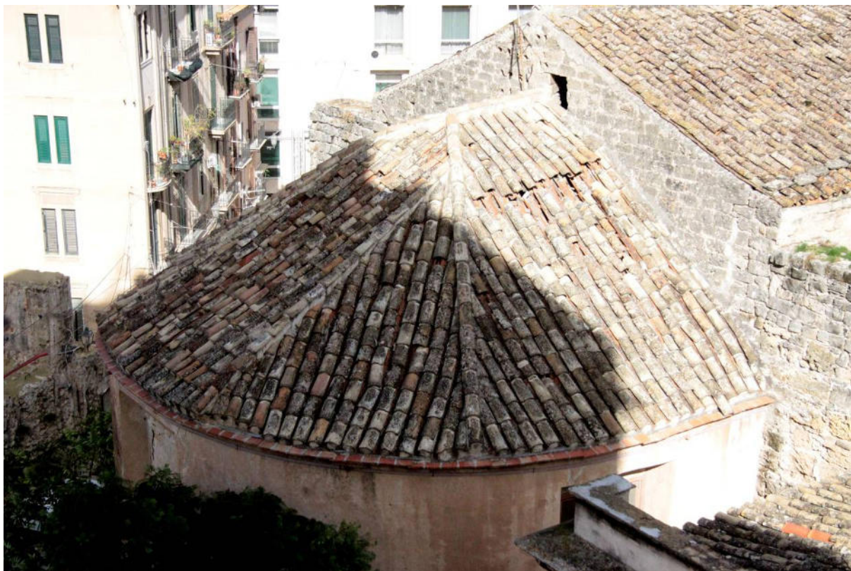
Vista del tetto della parte absidale. Si può osservare la totale assenza della linea di gronda.
