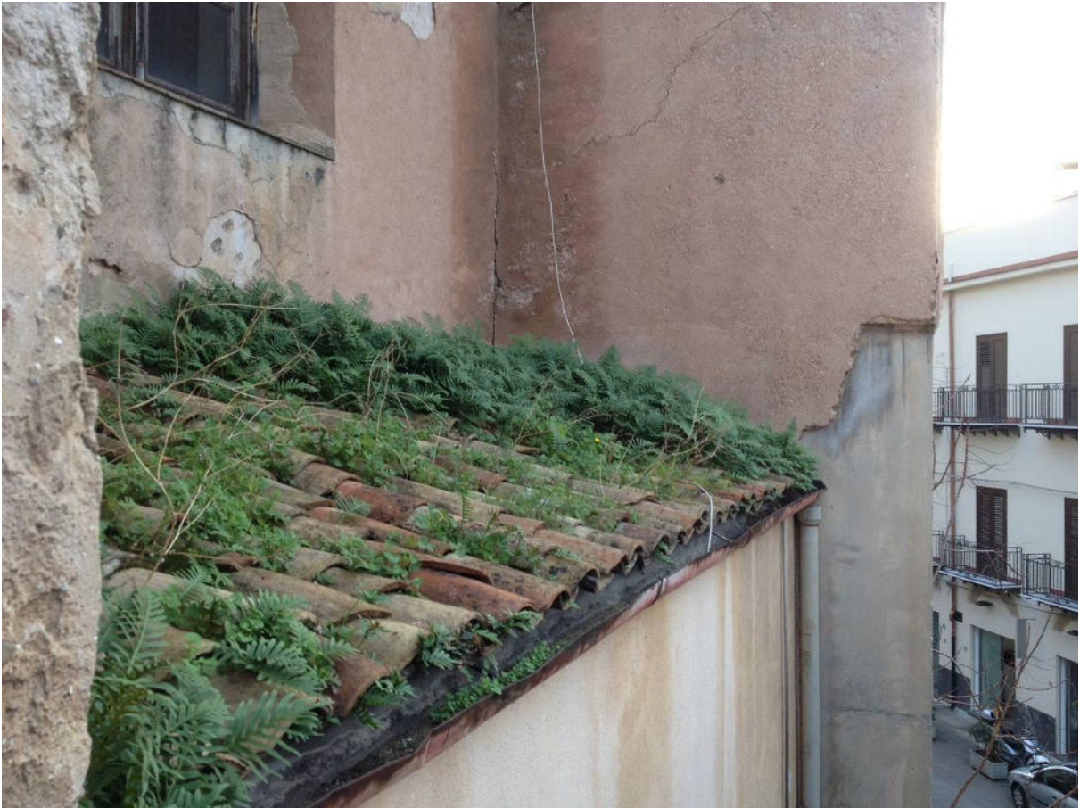
Presenza di vegetazione sul manto di copertura di una delle cappelle sul lato nord-ovest
