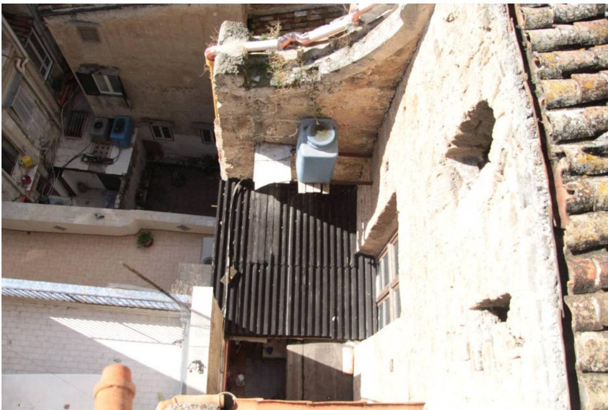
Vista, dal campanile, della superfetazione.
