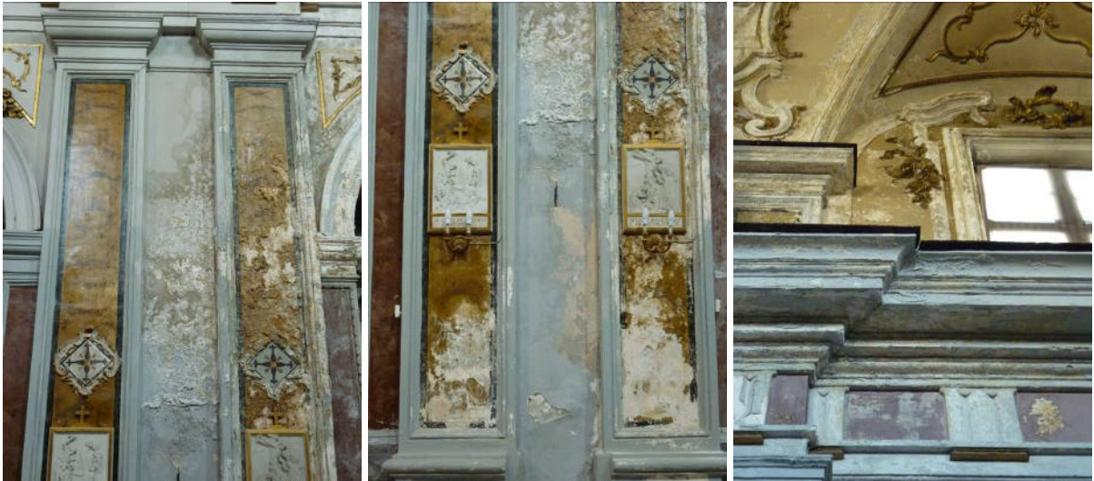
Presenza di sollevamenti e distacchi del l'apparato decorativo compromesso dalle infiltrazioni provenienti dalla copertura.
