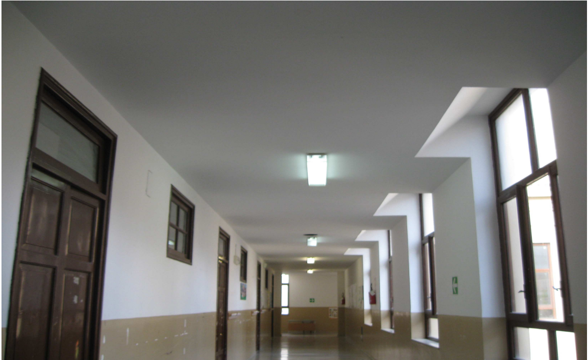
Foto 2: Controsoffitto non ispezionabile in cartongesso corridoio 1° e 2° piano
