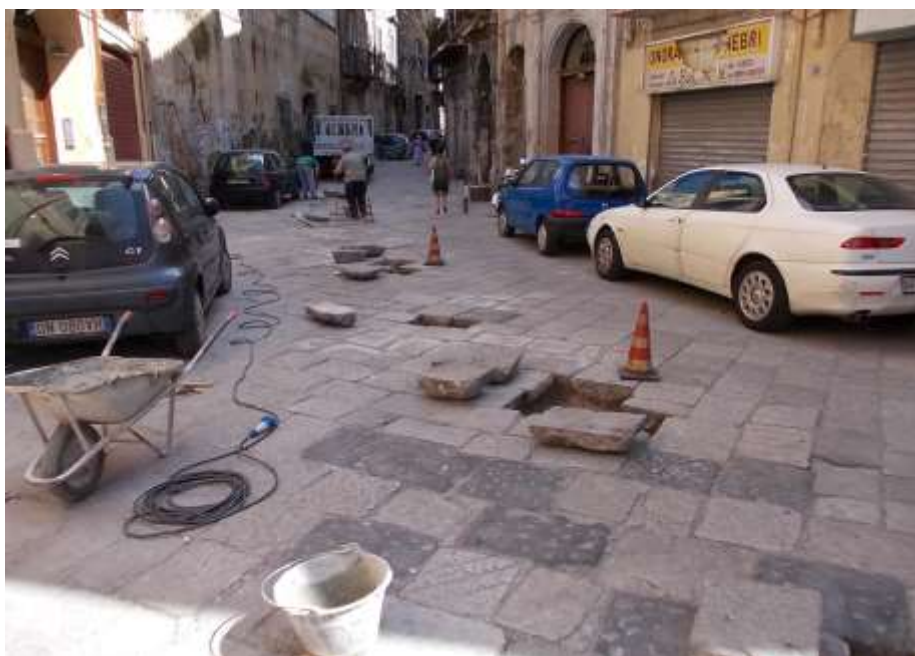
Esempi di interventi puntuali sulle basole eseguiti con lavori di pronto intervento
