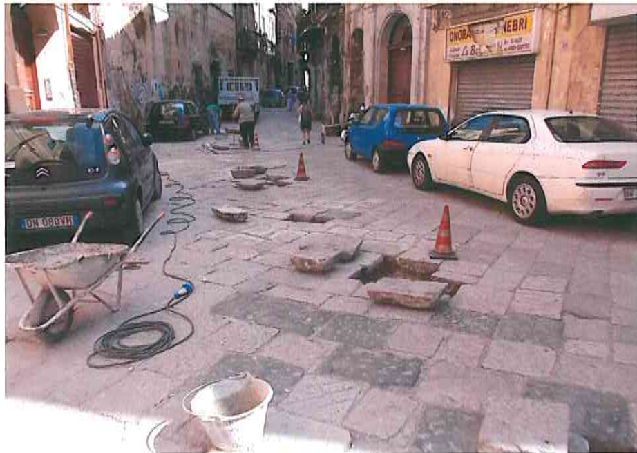
Via dell'Università - interventi puntuali sulle basole eseguiti con lavori di pronto intervento
