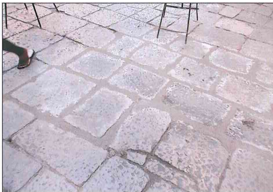
Interventi di sigillatura delle sconnessure dei giunti delle basole eseguiti con lavori precedenti
