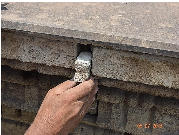
Frammento n.1 - Cornice aggettante in corrispondenza della terza mensola da destra del fronte 2-3
