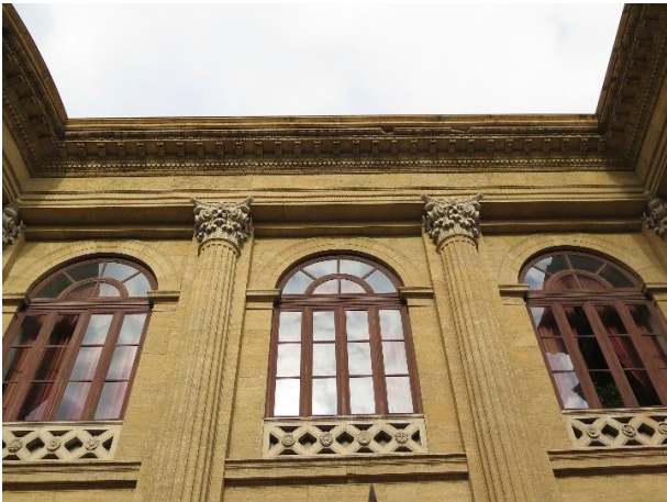
Frammento 4 - Cornice aggettante in corrispondenza della dodicesima mensola da destra del fronte 6-7
