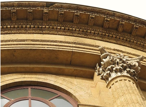
Frammento 5 - Cornice aggettante in corrispondenza della quarantanesima mensola da sinistra del fronte 7-8
